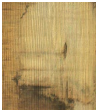
nobilitato legno marcio chipboard rotten wood
